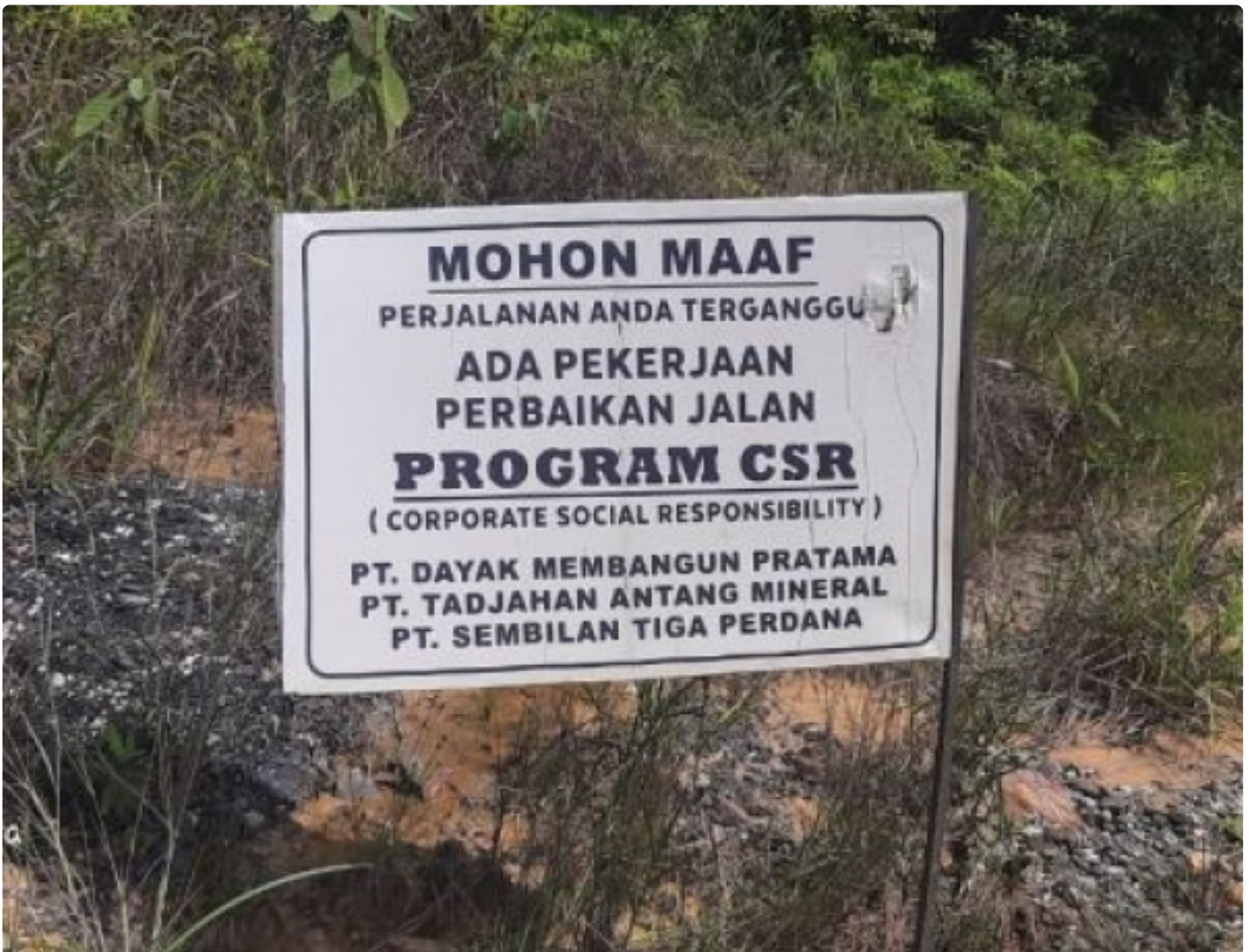
Plang Pekerjaan Yang Menyatakan Ada Dana CSR Dalam Perbaikan Ruas Jalan Provinsi Kuala Kurun - Palangka Raya di desa Teluk Nyatu, Gumas.
