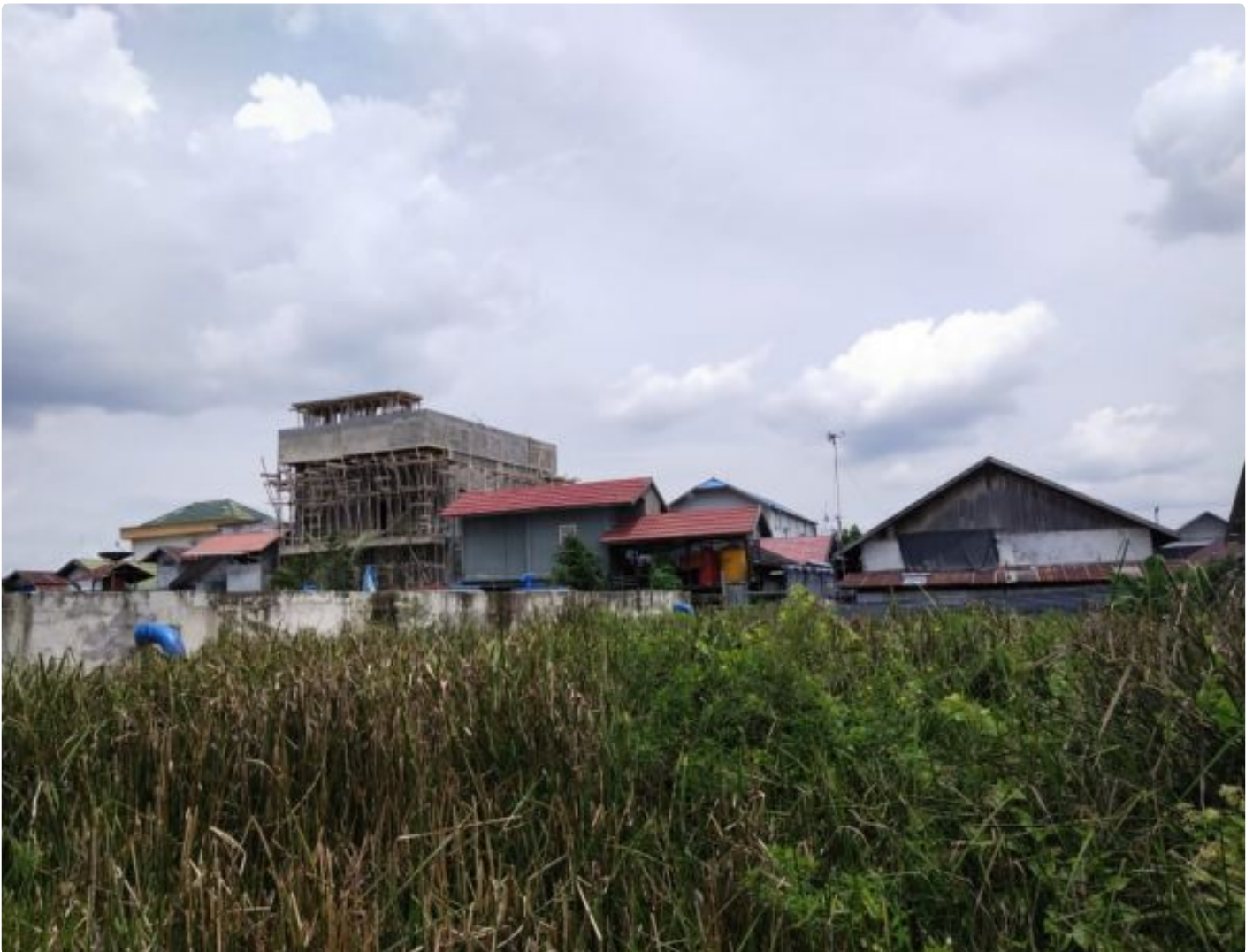
Bangunan Reser Power Milik PDAM Kapuas Yang Mangkrak , Kenalan Dana DAK 4,2 Milyar
