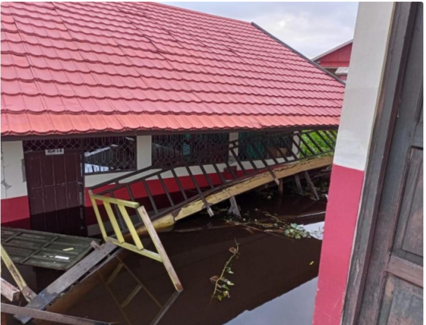
Bangunan SDN 14 Palangka Raya yang ambruk
